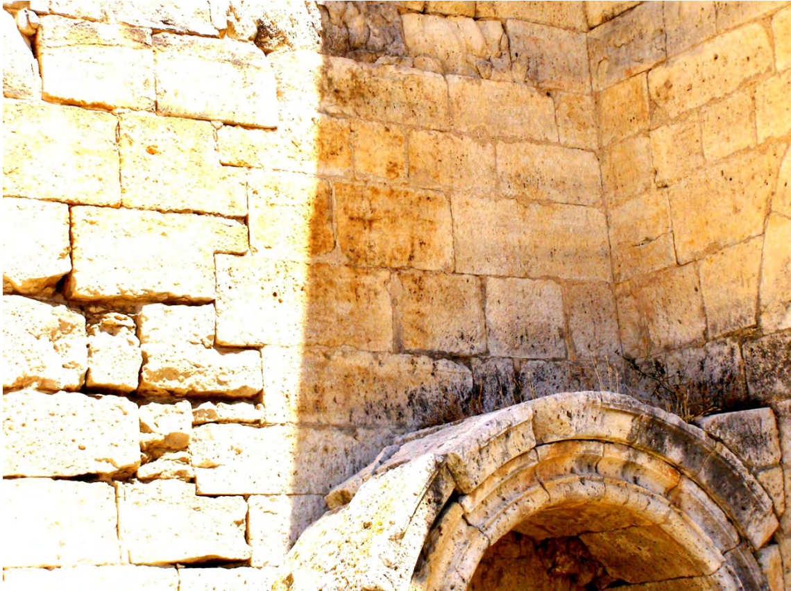
Irregularidades en las hileras Pared Sur S1 Foto 129 2007
