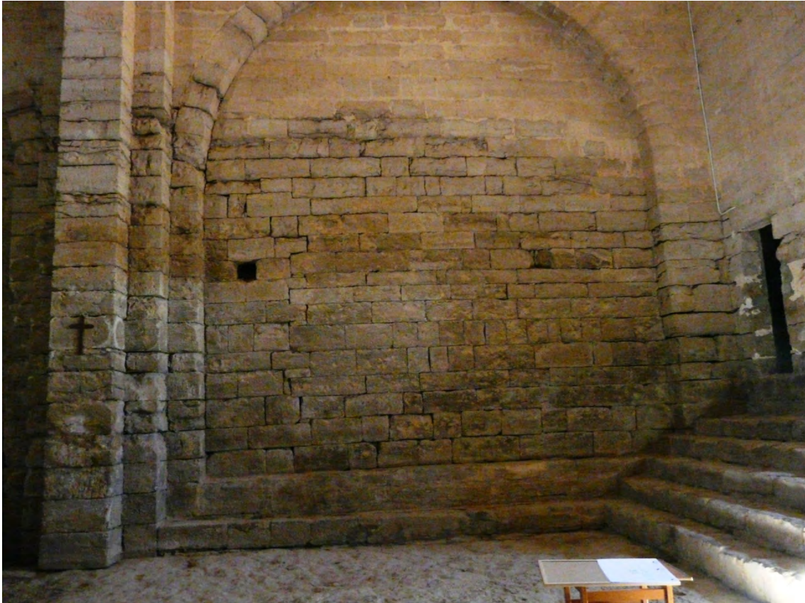
Irregularidades en las hileras Pared Sur s3 Foto 1870352
