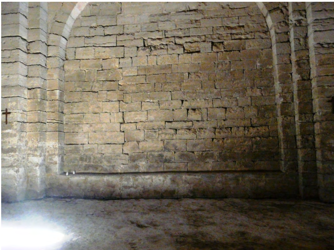
Irregularidades en las hileras Pared Sur s2 Foto 1870464
