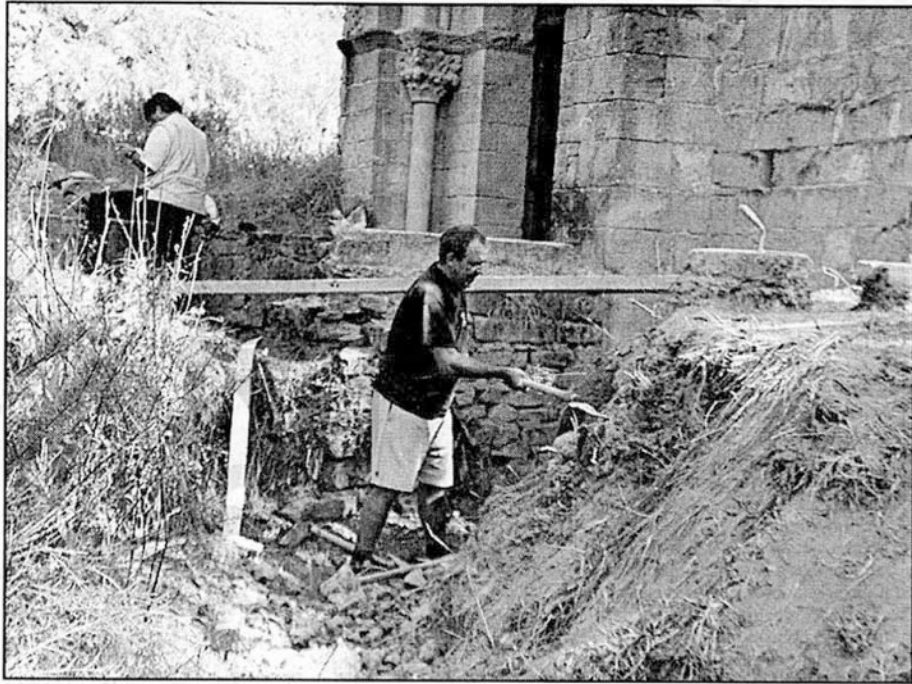
Trabajos en la zanja exterior de la iglesia de San Adrián de Sasabe
